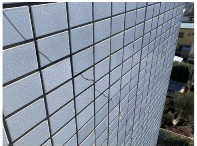
外壁タイルひび割れ状況
