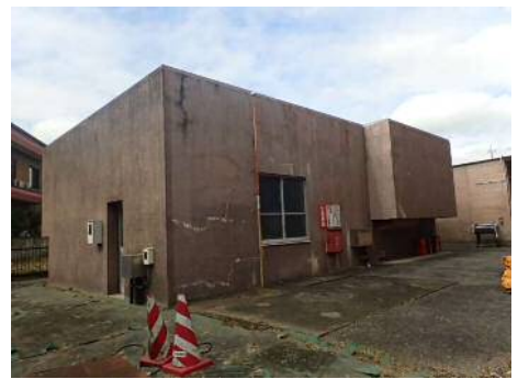
運河出張所発電機室
