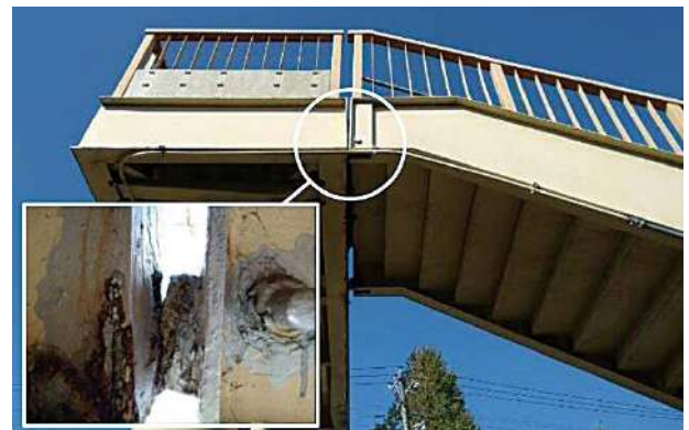
写真-2 フック部の破断
