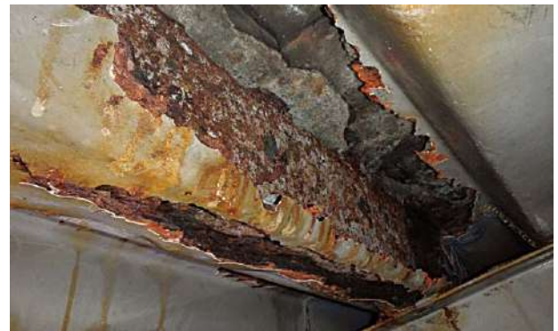
写真-1 波型鋼板形式の床版の大規模な欠損
