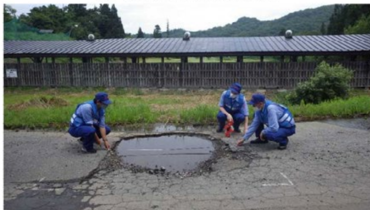
舗装ポットホールの状況(町道高明荷沢線)
