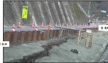
路面沈下の発生状況(R3.3.26)
