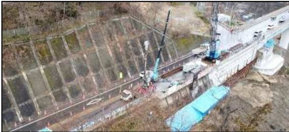
路面沈下の発生状況 ドローン撮影(R3.3)
