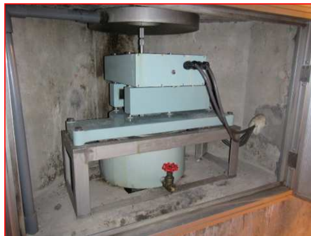
【プラムライン（堤体観測設備） （更新対象）】
