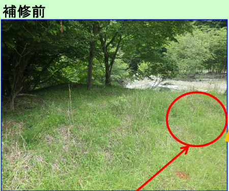
注意喚起看板の未設置 危険箇所に侵入する可能性あり。
