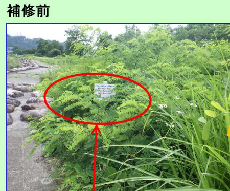
注意喚起看板が草により見えない 注意喚起内容を見落 とされる可能性あり。
