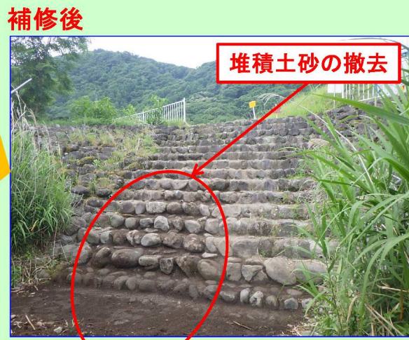
堆積土砂撤去により、 昇降時の転倒を防ぐ。
