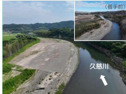
R2久慈川左岸小貫地先 河道掘削外(その1)工事 (株式会社梅原工務店)
