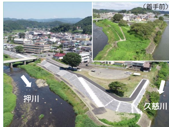
R2久慈川右岸大子地先上流築堤護岸工事 (北都建設工業株式会社)
