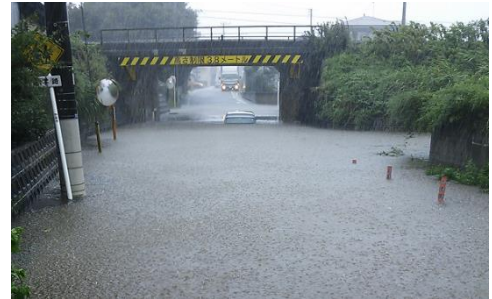
冠水状況(平成25年8月)集中豪雨 市道 11019号線 川間ガード下 (道路冠水箇所リストNo27)
