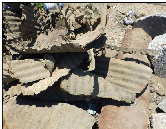
既設円形水路の腐食状況
