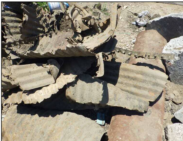
既設円形水路の腐食状況
