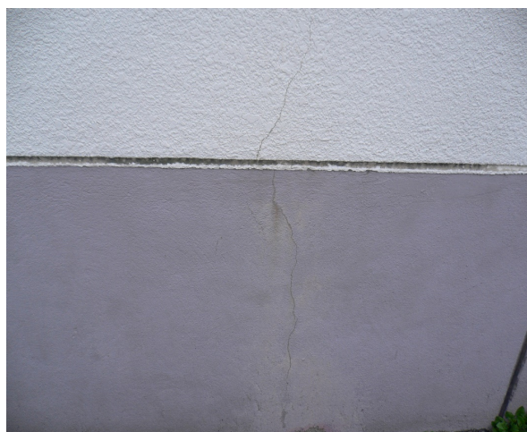
外壁クラック
