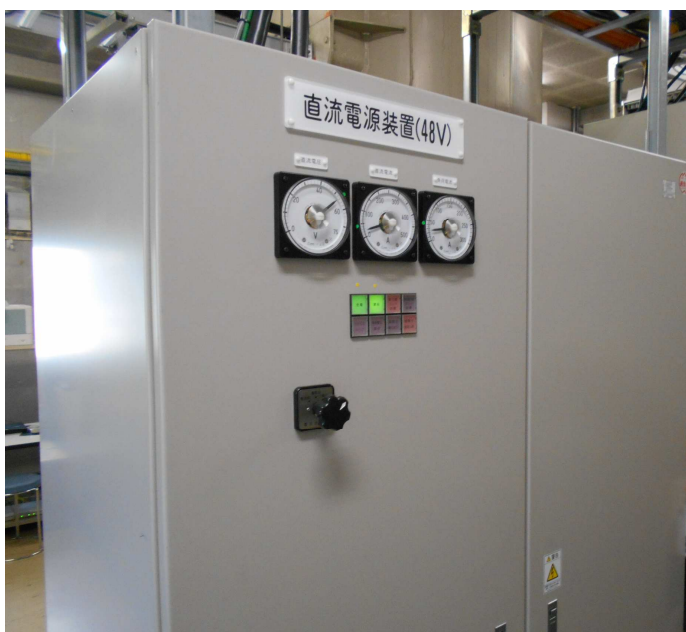
【直流電源装置】
