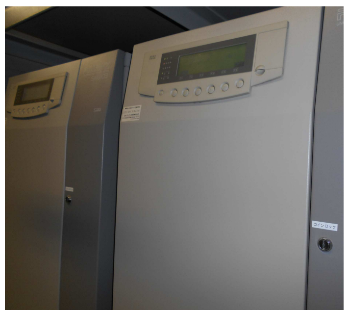
【無停電電源装置】
