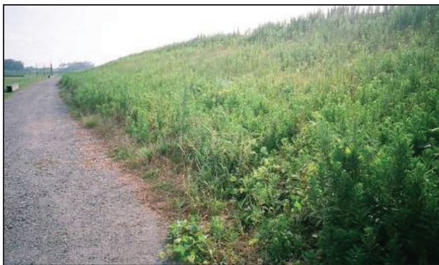
堤防の斜面が利用しにくい
