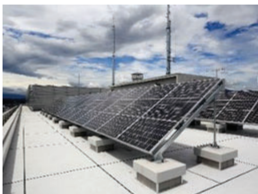
太陽光発電設備
