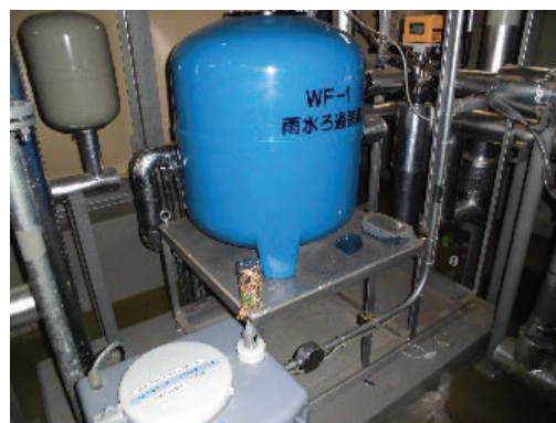
雨水利用設備
