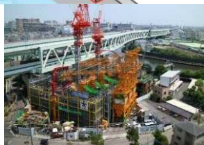
王子第二ポンプ所 (北区堀船、東十条)
