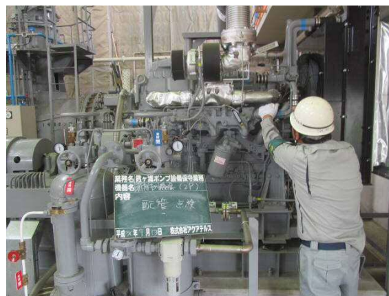
ポンプ設備の点検(新附洲機場)
