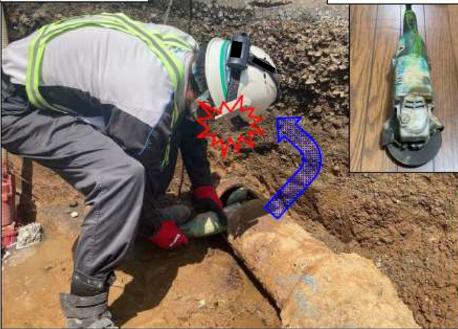
被災状況写真
