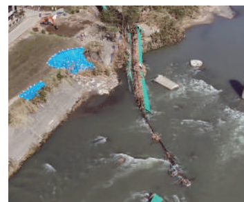
落橋したJR水郡線第6橋梁
