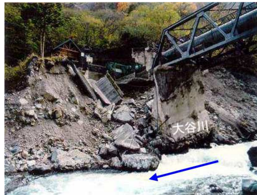
発電用取水施設の被災状況(H10)
