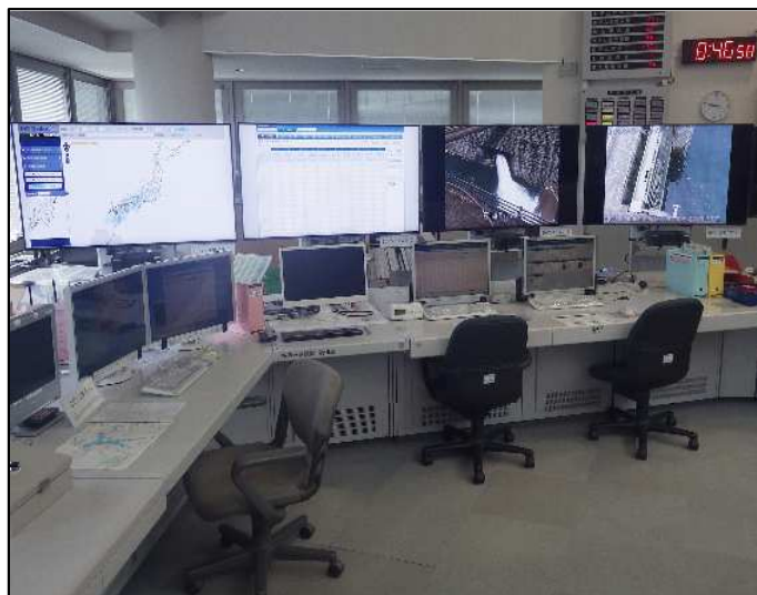
ダム管理用制御処理設備
