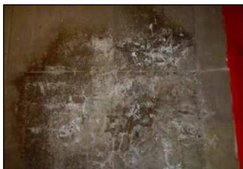
▲床版損傷状況 (ひび割れ)
