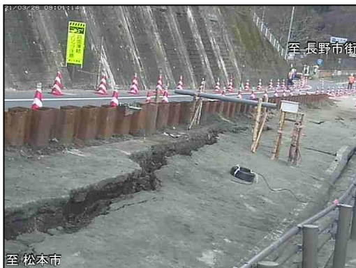
路面沈下の発生状況(令和3年2月)
