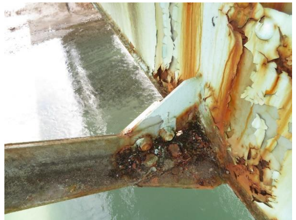
橋梁下部支持材腐食状況(近景)
