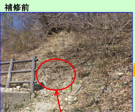
立入禁止策の未設置 危険箇所へ侵入して 転倒する危険性あり。
