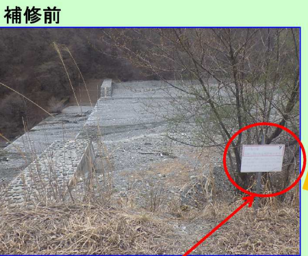
注意喚起看板の劣化 注意喚起内容を見落とされる可能性あり。
