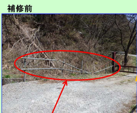
立入禁止柵の損傷 危険箇所へ侵入して 転落する危険性あり。
