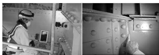
ヘッド装着のカメラにて撮影 写真－1 A橋：き裂（アクションカメラ）
