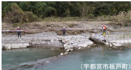
■令和元年東日本台風による被災状況
