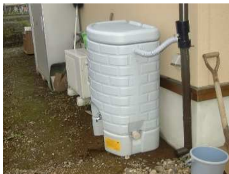
雨水貯留施設(タンク)
