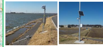
危機管理型水位計・監視カメラの整備【国・茨城県】
