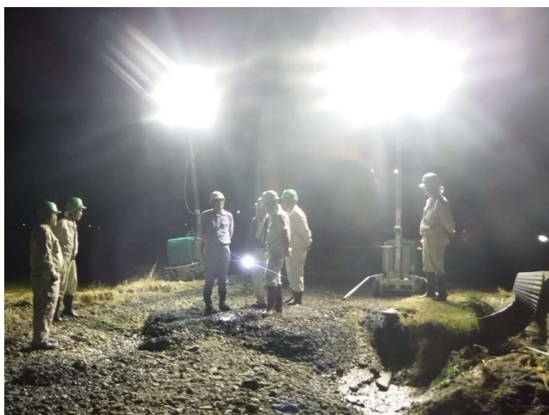
令和元年 10 月（久慈川左岸 27k 堤防決壊箇所）
