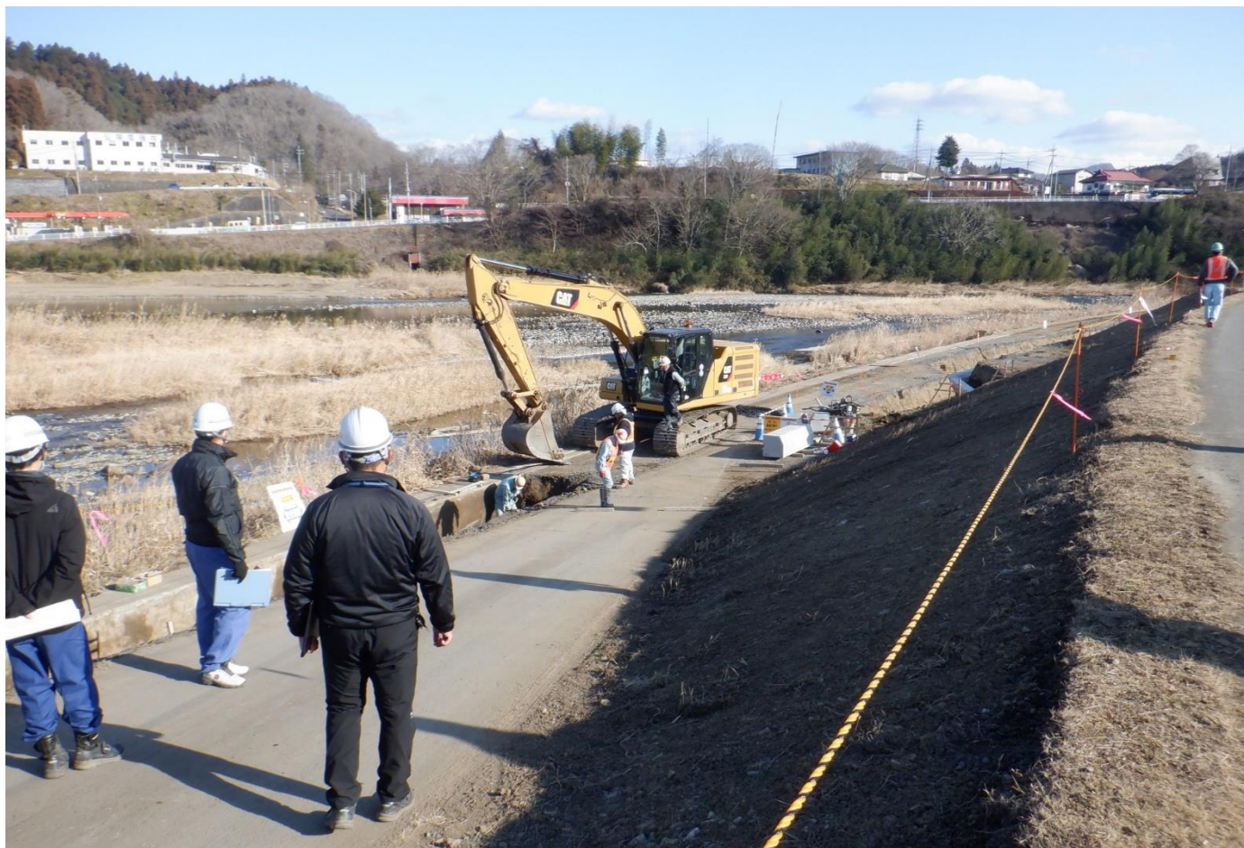
R2久慈川右岸大子地先下流築堤護岸(その2)工事（久慈郡大子町大子地先）
