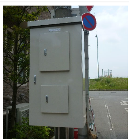
樋門操作盤（新設）
