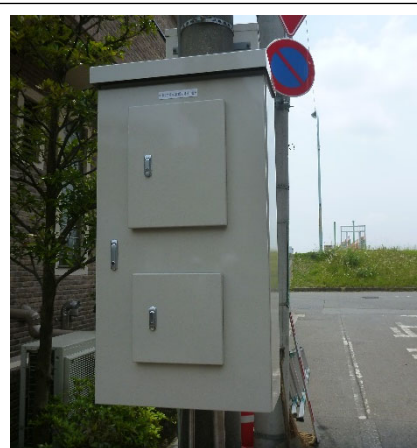
樋門操作盤（新設）
