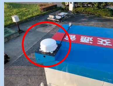
通信用アンテナ
