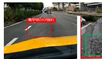
②舗装の損傷状況を自動計測
