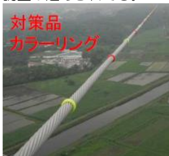
千葉県野田市での設置状況（写真：東京電力）
