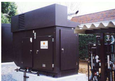
非常用発電機
