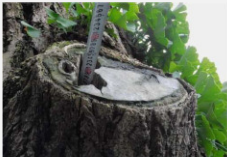
大枝切断面への腐朽の侵入
