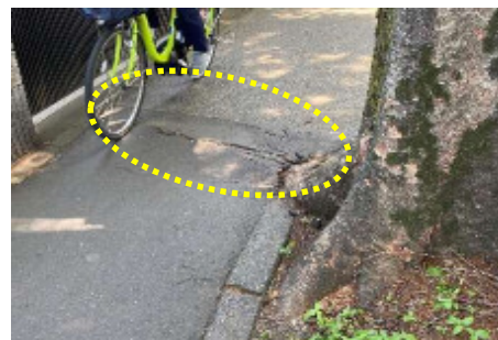
根上り発生状況
