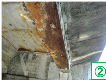
車道として供用されていた際に耐荷重のため設置されていた補強鋼板を撤去
