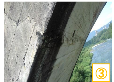
アーチリブやアーチ支柱のひび割れはコンクリートで補修
