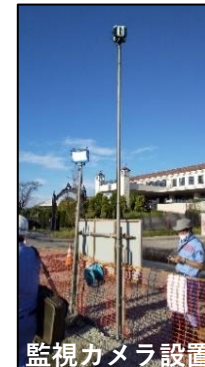
監視カメラ設置
