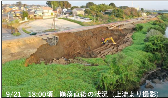
9/21 18:00頃 崩落直後の状況（上流より撮影）
