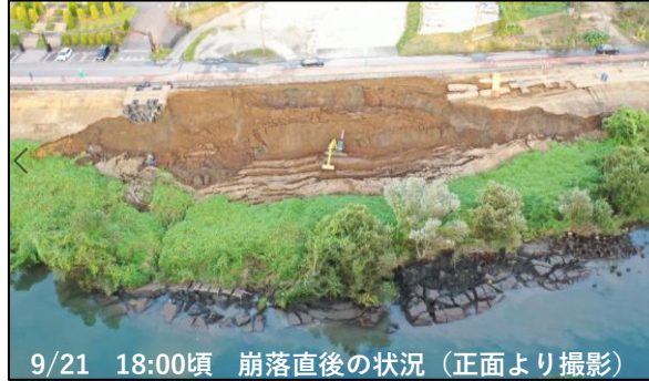
9/21 18:00頃 崩落直後の状況（正面より撮影）
