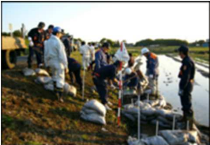
下妻市の漏水の様子(H16.10)
