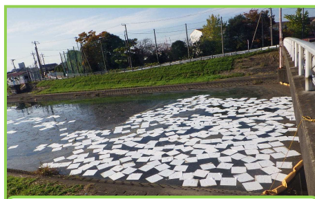
仲道橋に設置した対策工
