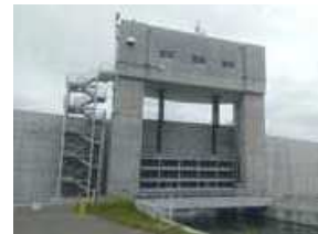
自動化・遠隔化した水門
