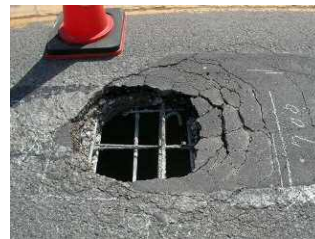
【道路が損傷した例】
