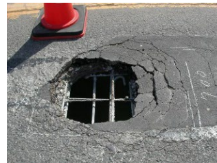
【道路が損傷した例】
