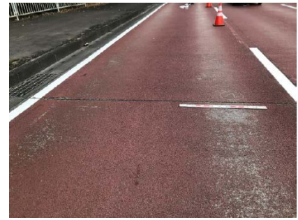
写真1 すべり止め舗装の飛散状況
