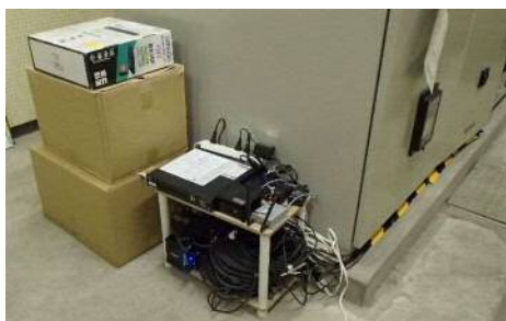
写真-1 計測装置設置状況
