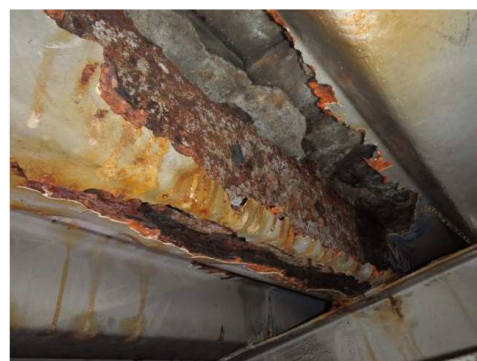
図-2 床版の踏み抜きの恐れのある状態
