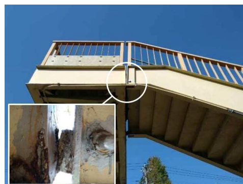
図-3 接続部の腐食、亀裂
