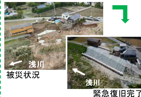
浅川（右岸1.2k）決壊箇所 【常陸太田市松栄町】
