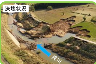
令和元年10月撮影（被災直後）
