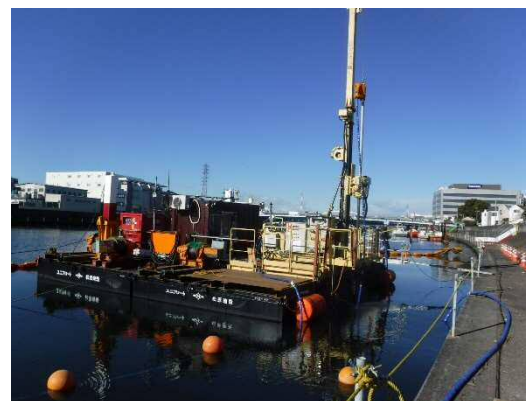
耐震対策施工状況(低変位超高压噴射攪拌工法) (栄町地先の事例)
